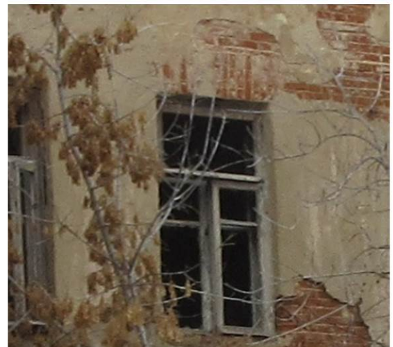
Прямоугольный оконный проем, кирпичная клинчатая перемычка над окном 2-го этажа восточного дворового фасада (лит. А), 2018 г.
