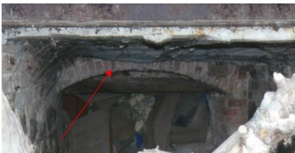
Кирпичная арочная лучковая перемычка над проемом в подвал, пристройка (лит. а) восточный фасад, 2019 г.
