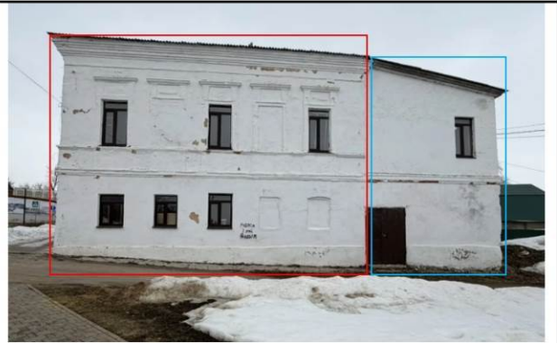
Д. 15, красным контуром выделен основной объем (лит. А), голубым – пристройка (лит. а), южный лицевой фасад
