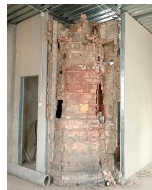
Печь помещения №8, первый этаж
