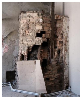
Печь помещения №3, первый этаж
