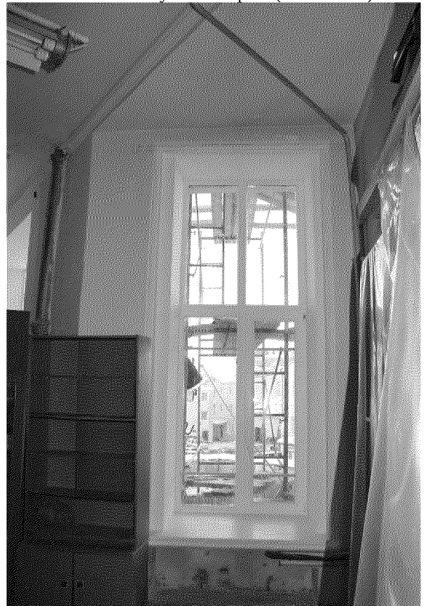
Видовая точка № 49. Профильное обрамление оконного проема (26.11.2020)
