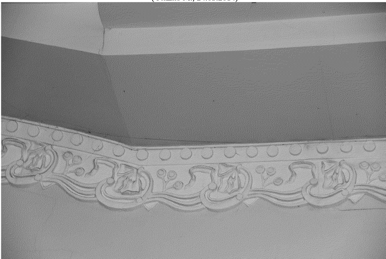
Видовая точка № 8. Фрагмент настенного лепного декора (23.11.2020 г.)
