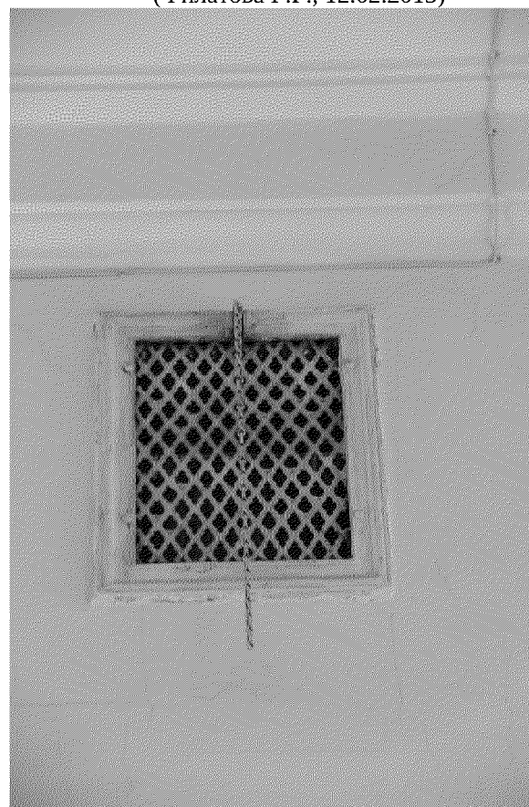
Видовая точка № 56. Металлическая вентиляционная решетка (26.11.2020)
