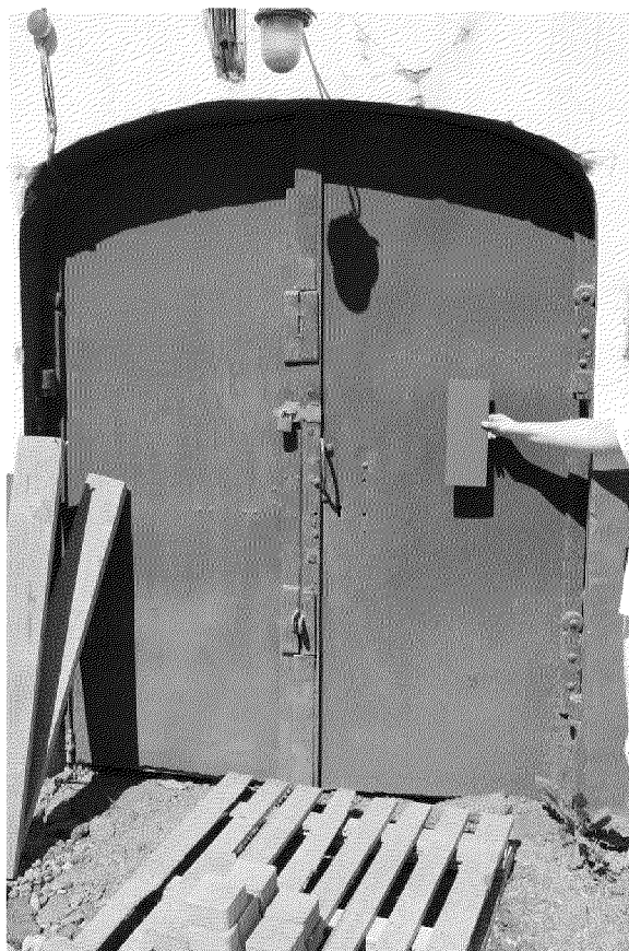
Видовая точка № 57. Фрагмент дворового фасада. Металлическая дверь спуска в подвал (15.07.2020)
