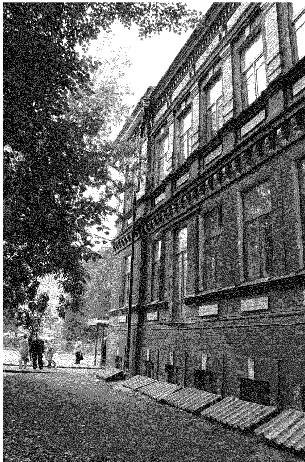
Видовая точка № 4. Фрагмент восточного фасада с дверью выхода на балкон 1-го этажа (утрачена)
