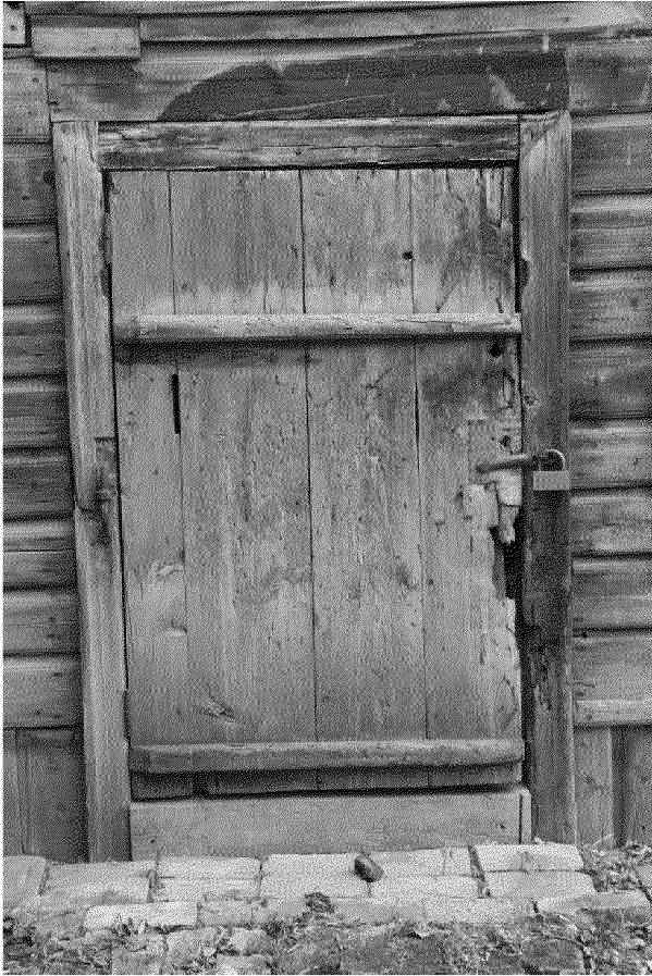
Видовая точка № 16. Дошатая на шпонках дверь пристройки (дата съемки: 06.11.2019 г.)
