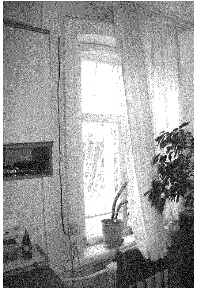
Видовая точка № 12 Оконная коробка с профильным обрамлением и подоконником (Рыжикова А.Ю., 18.09.2017 г.)
