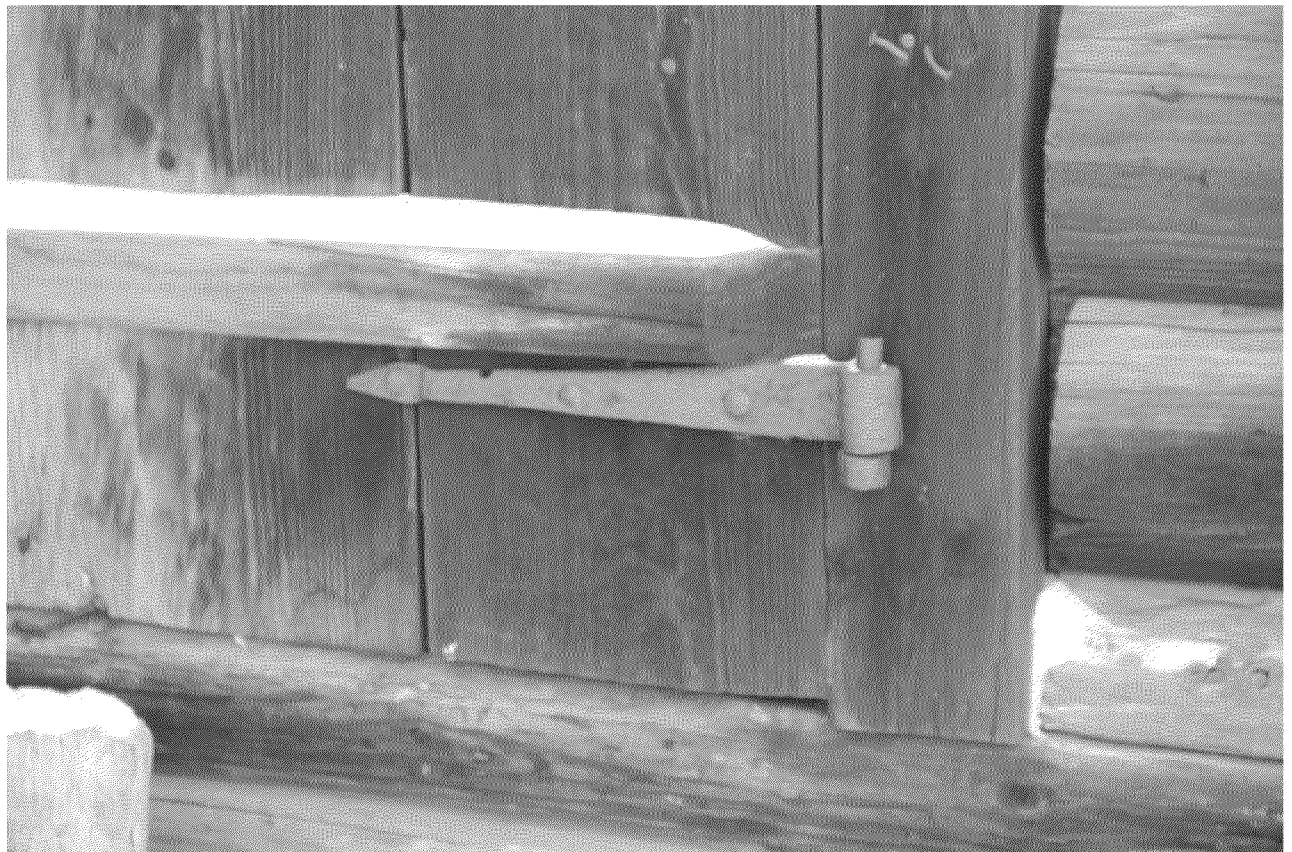
Видовая точка № 14. Фрагмент дверей 2-го этажа. Кованый навес. (фото: Яблонской М.А., 2019 г.)
