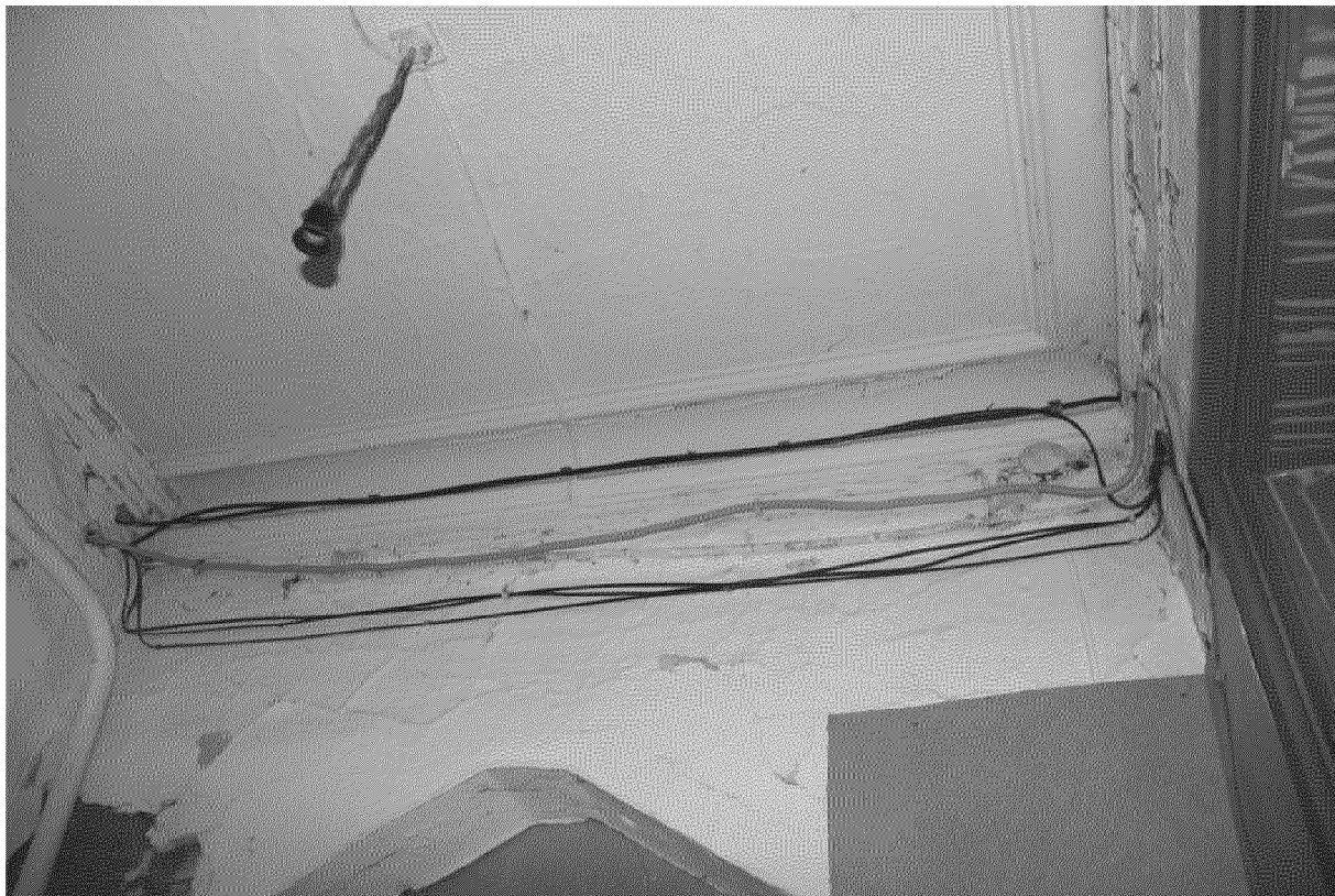
Видовая точка № 19. Профильные потолочно-стеновые штукатурные тяги в помещении 2-го этажа пристройки восточного фасада.
