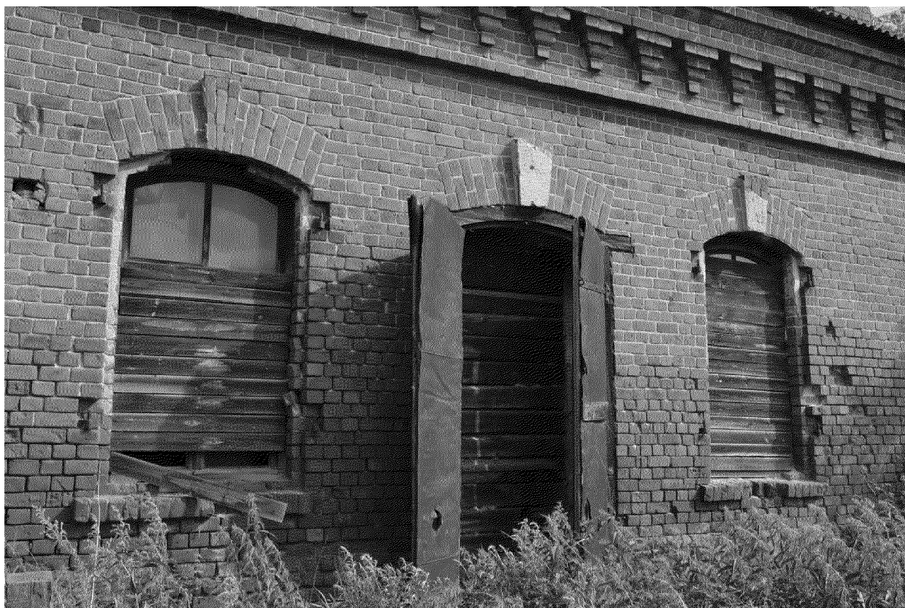
Видовая точка № 8. Фрагмент южного фасада (окна и двери в восточной части) (автор снимка: Литвинова О.Г., дата съемки: 28.07.2017 г.)
