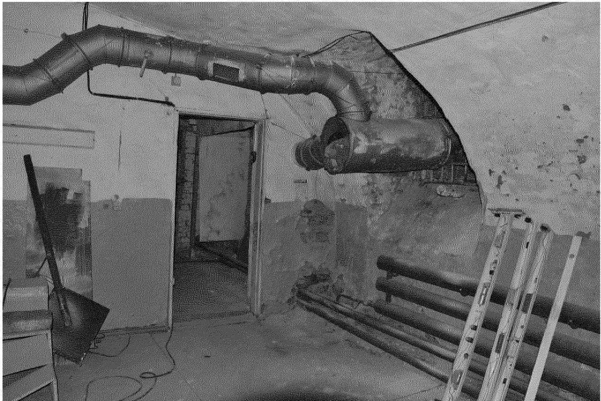
Видовая точка № 16 Помещение подвала. Оконный проем в кирпичном своде (фото: Леонтьевой Н.М., 07.05.2014 г.)
