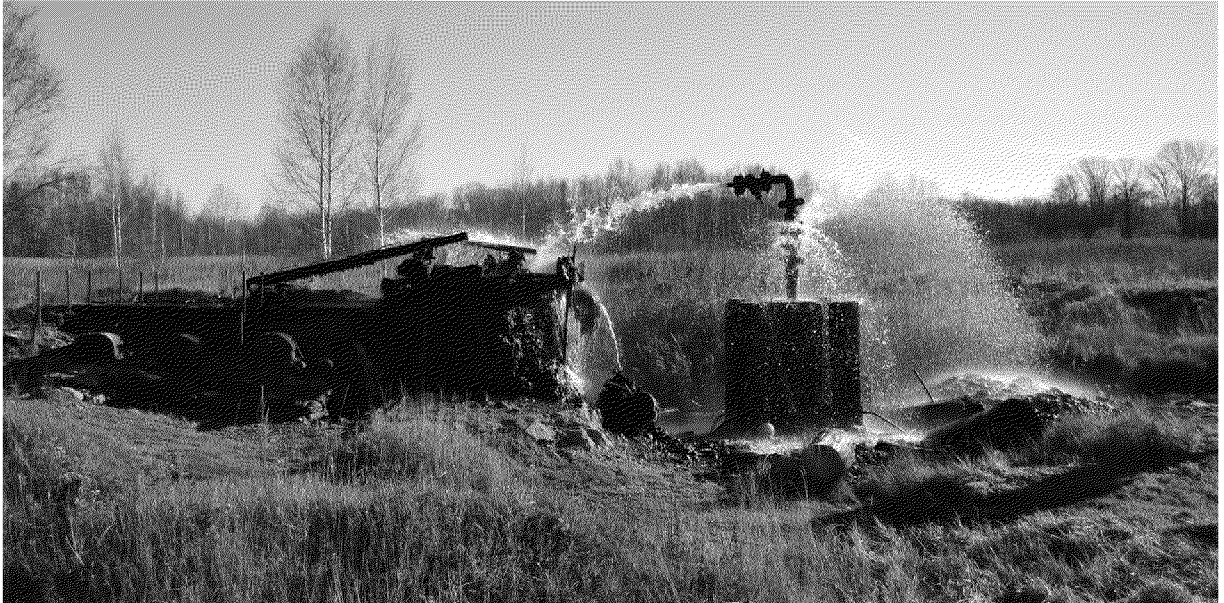
Видовая точка № 1. Общий вид скважины. (18.10.2015 г.)
