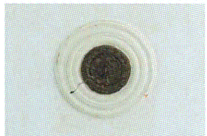
Потолочная розетка. Пом. 151
