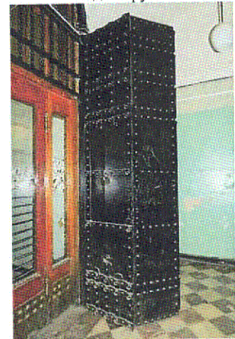
Пом.1.4 Полотно с внутренней стороны
