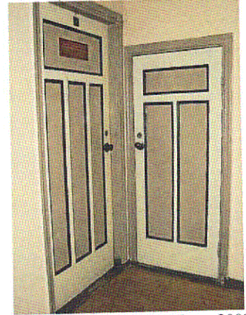
Двери в пом. 2.14 и 2.16. Фото 2009 г. (необх. восстановление)
