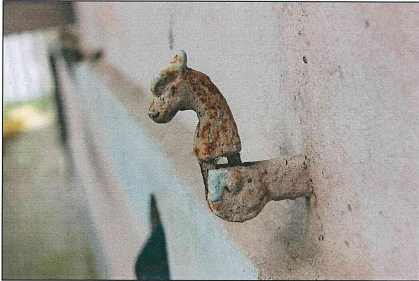
Фото 16. Южный фасад объекта. Стены, карнизы. Удерживающие декоративные металлические конструкции, вмонтированные в стены, в виде лошадиных головок, с поворотными механизмами.
