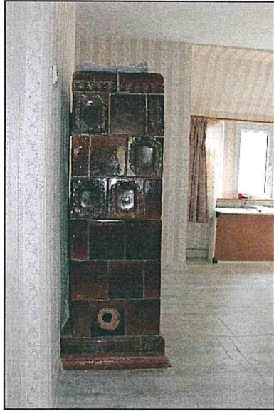
Фото 26. Второй этаж. Печь.
