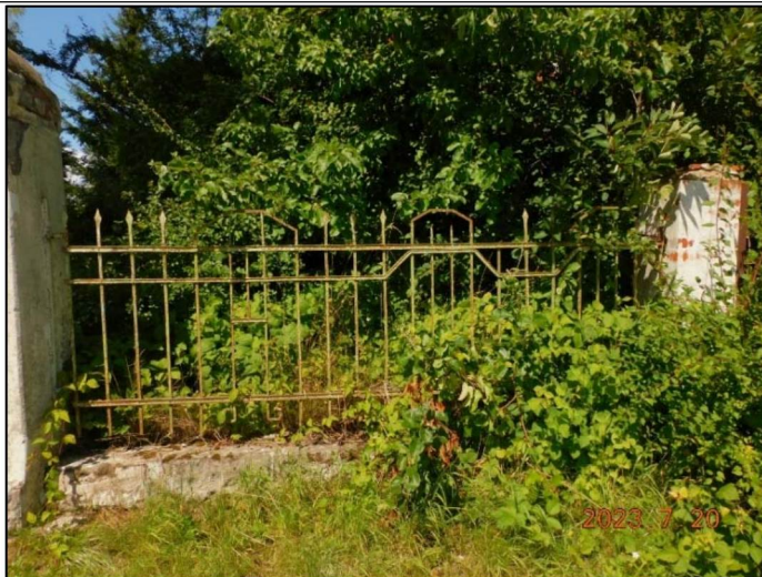
Фото 3. Кованый пролет ограждения.
