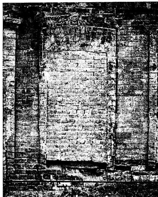
Фото 17. Ул. Грязнова, 34, лит. Б. ОКН «Застройка ул. Грязнова. Усадьба Ковалёвой: два жилых дома». Общий вид со двора. Фрагмент северо-западного фасада. Заложенный оконный проём первого этажа. Фото 2017 г.
