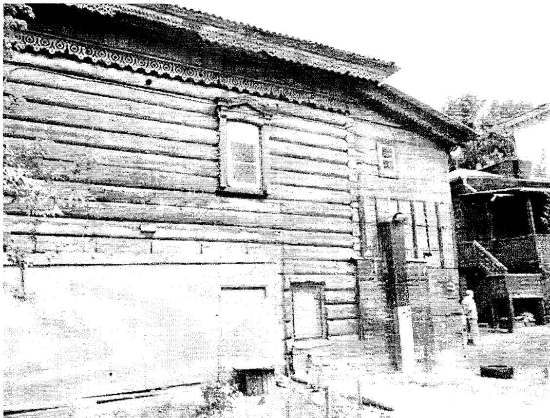
Фото 26 - Фрагмент торцевого, дворового (юго-восточного) фасада жилого дома (лит. А). Место примыкания снесенного позднего пристроя гаража. Поздние дверной и оконный проем в уровне 1-го этажа
