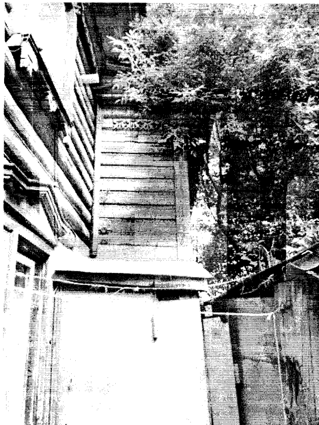
Фото 13 - Фрагменты продольного северо-восточного фасада основного объема и юго-восточного фасада прируба парадного входа
