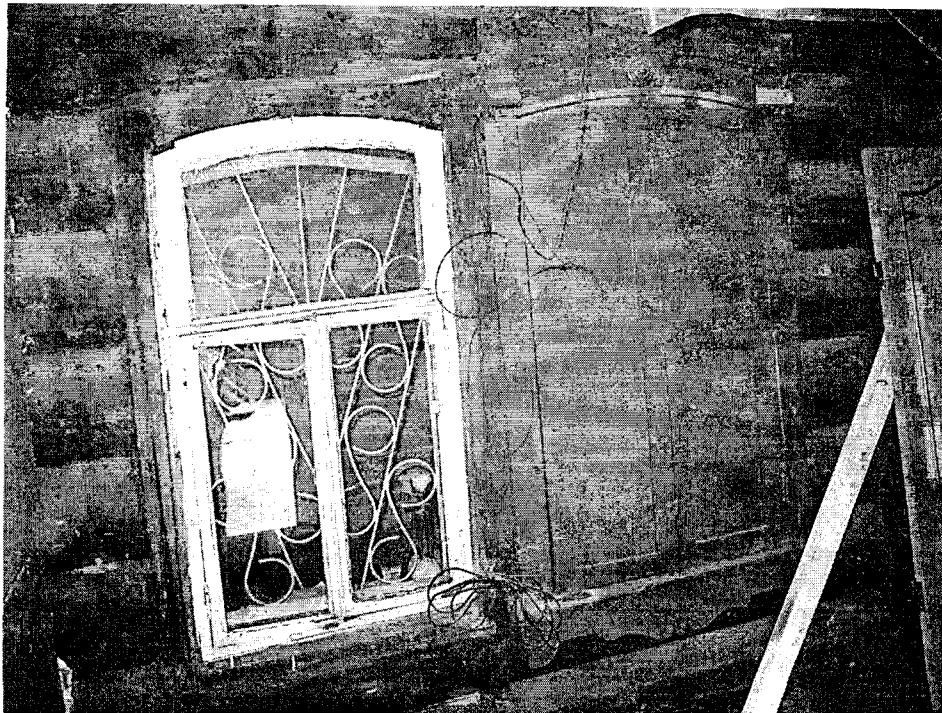
Фото 32 - Фрагменты продольного, дворового (северо-восточного) фасада жилого дома (лит. А) (архив ЦСН, 2011 г.). Сдвоенное окно 1-го этажа, закрытое поздним пристроем в открытой галерее
