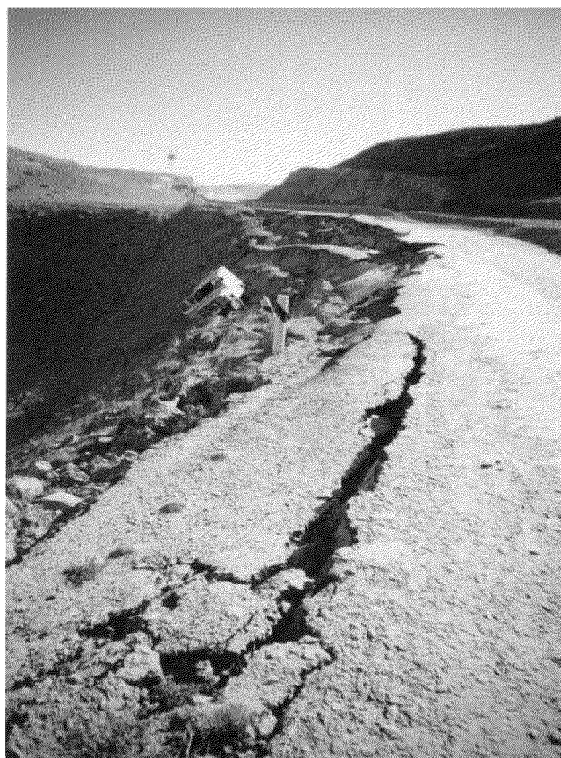
Рис.5. Ситуация на Чуйском тракте. Результат Чуйского землетрясения 2003 года. Фото И.С.Новикова.
